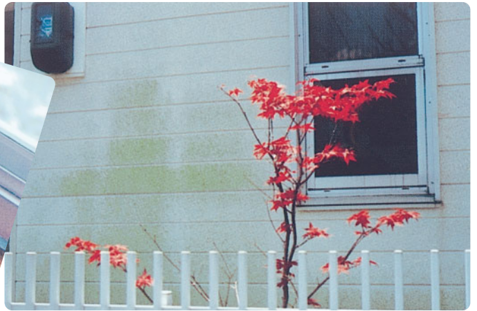
▲藻の被害を受けた外壁 ◀かびの被害を受けた住居
